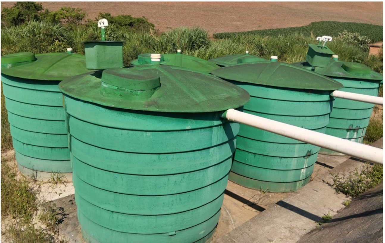
Foto 2 – Tratamento Secundário composto por Reatores UASB seguidos de Filtro Anaeróbio.
