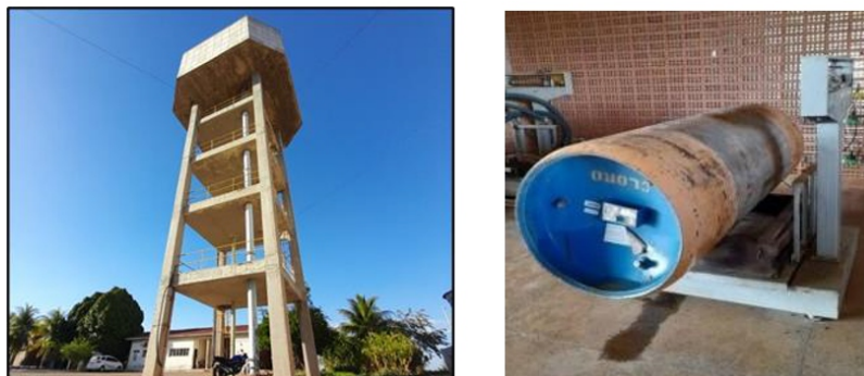
Figura 5 - Reservatório onde ocorre a cloração (a) e cilindro de cloro (b).
