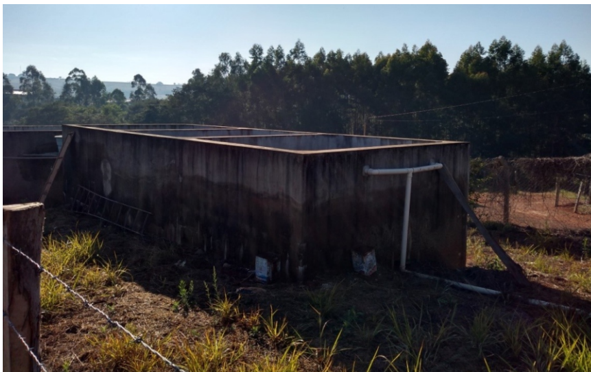
Foto 1 – Vista do Reator Anaeróbico de Chicanas (RAC)
