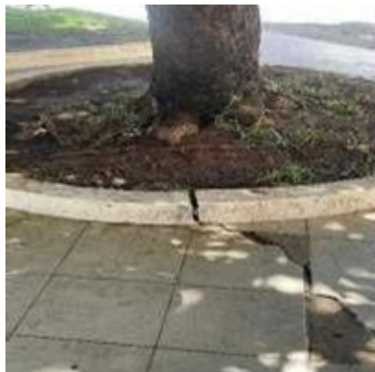
Imagem 10 - Planta 1 – Rachaduras de piso e cupins.
