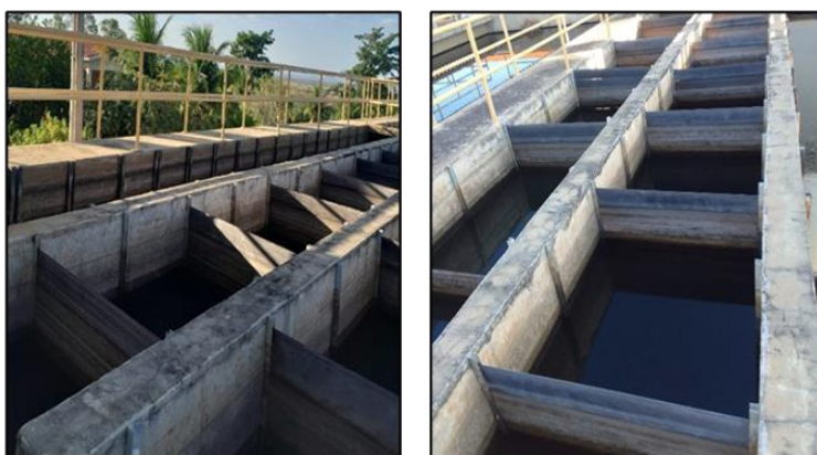
Figura 2- Chicanas utilizadas na etapa de floculação. Fonte: Autoria própria (2023).
